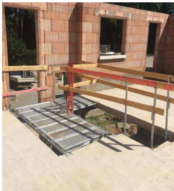
2 - Trémies d'escalier / ouvertures donnant sur le vide
